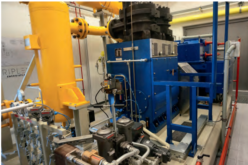
Abb. 6: Erdgas-Druckreduzierstation Hohfirst mit Gasexpansionsmotor von Spilling Technologies (blau, im Vordergrund der Motor, dahinter der Generator): Stromerzeugung durch Energie-Rückgewinnung bei der Gasexpansion.
