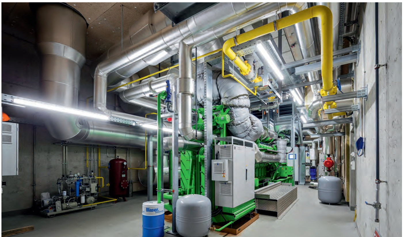
Abb. 3: Gross-BHKW in der Fernwärmezentrale Au mit 2 MW elektrischer Leistung als wichtiges Element der Sektorkopplung.
