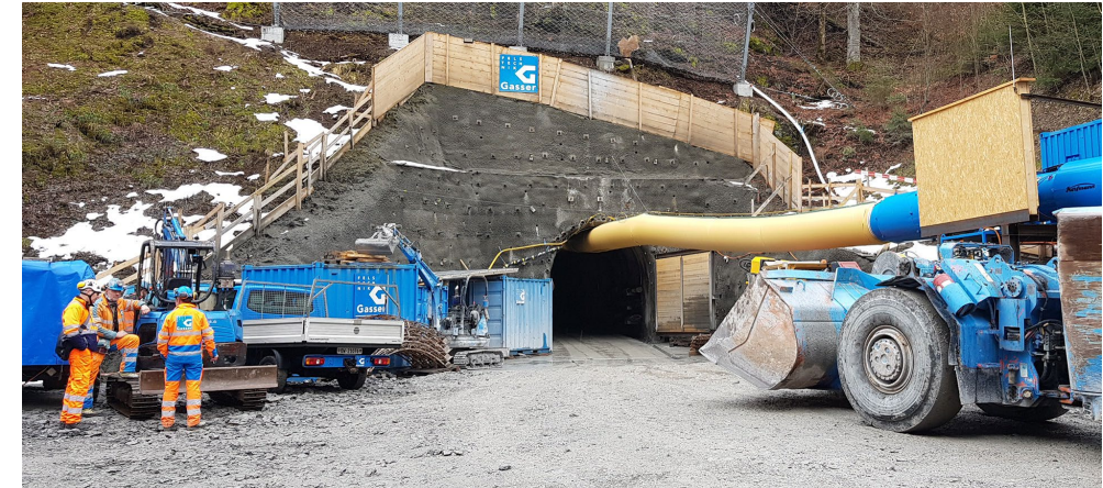
Wasserkraftwerk Soubach: 30.6 GWh
